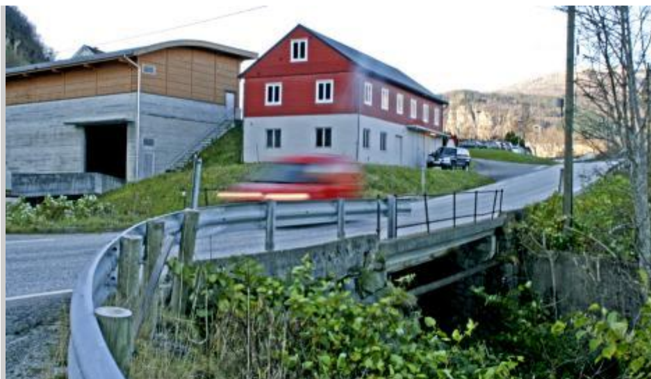
Kaldestad bru i Norheimsund er moden for utskifting. E. Opedal & Sønner bygger bruene som erstatter den. Foto: Katrine Helgheim
